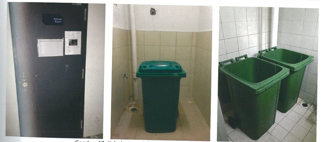
Gambar 47: Kebuk sampah bagi pembangunan berbilang tingkat
