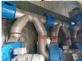
Fan Header & Check Valve
